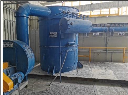
FOTOGRAFÍA 5. AIR LIFT Y FILTRO DE MANGAS
