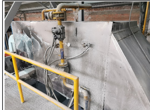
FOTOGRAFÍA 4. QUEMADOR TORRE DE SECADO
