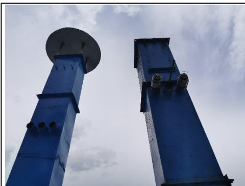
FOTOGRAFÍA 7. DUCTOS DE DESCARGA
